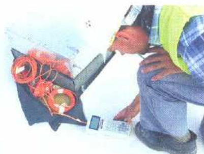
Flachdachüberwachung mit einer Leckmeldeanlage der PROGEO-Monitoring GmbH.
