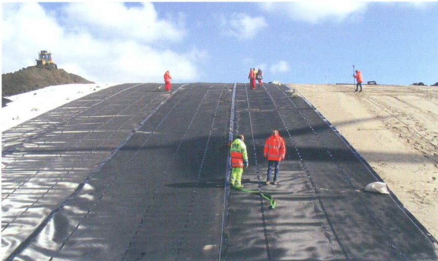
Auf einer 40.000 m 2 großen Fläche der Deponie Tonnenmoor im niedersächsischen Vechta wurde die Kontrollanlage installiert
