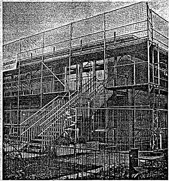
Weil das begrünte Flachdach einer Kindertagesstätte in Münster seit dem Sommer 2007 wegen massiven Feuchtigkeitsschaden saniert wird, spielen die Kinder auf einer Baustelle.
