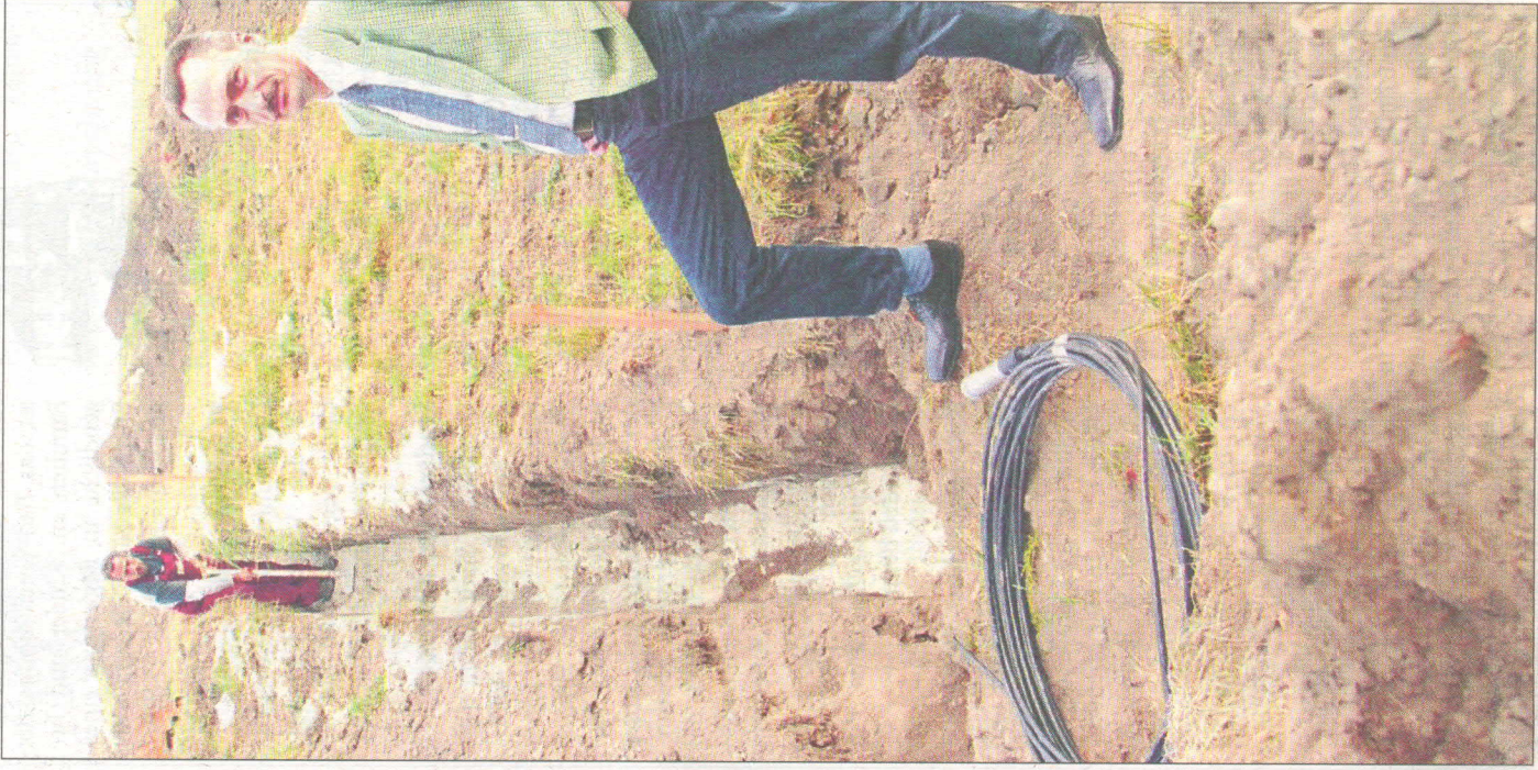
Eine in Deutschland neue Umwelttechnik baut die Abfallwirtschaftsgesellschaft Vechta – hier Geschäftsführer Clemens Nüske (rechts) – in ihre Deponie Tonnenmoor ein. Foto: Rara
